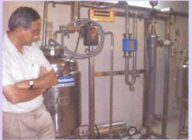
जीएनएमडीटीसी, डहाणु में नीरा फिल्ट्रेशन फैसिलिटी
